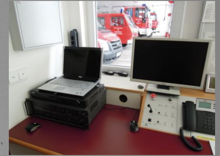
Zentralsteuerung in KDO Zentrale
